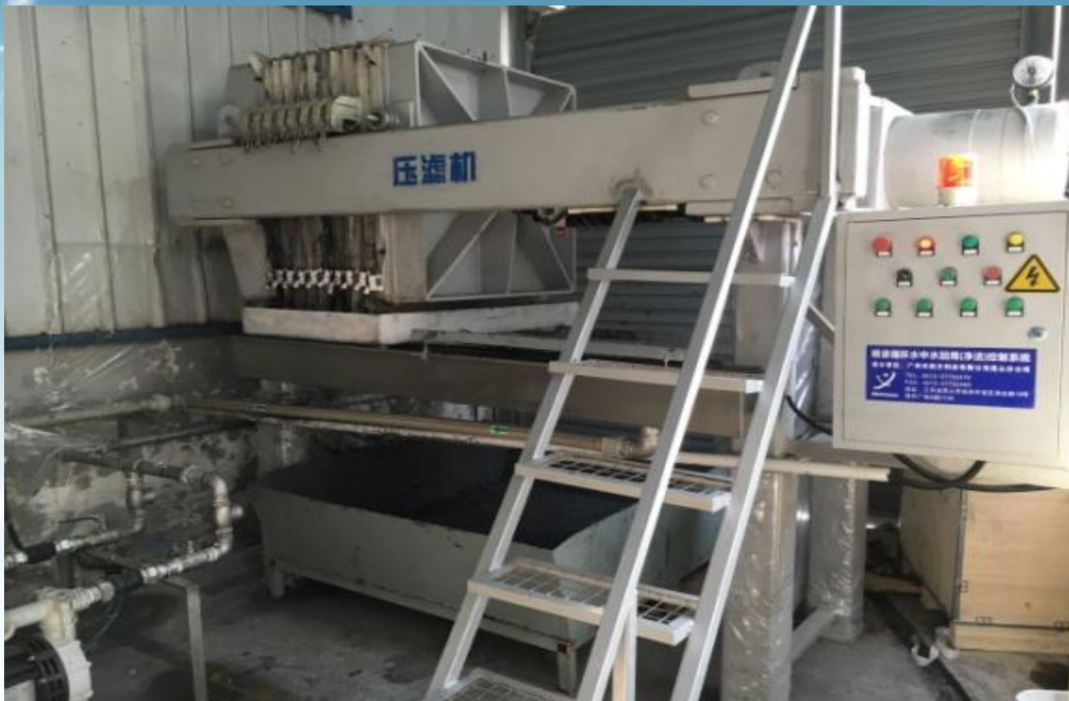
漆渣板框式脱水機
